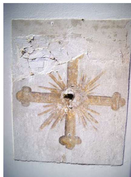
Zacheuszek (znak konsekuracyjny) na północnej ścianie prezbiterium (fot. A. Wysokińska)
